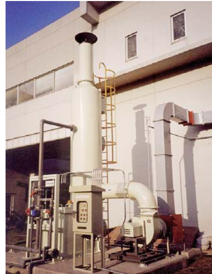
研磨工場 (煤塵処理)
