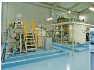
排水処理設備の 防液堤&ライニング
